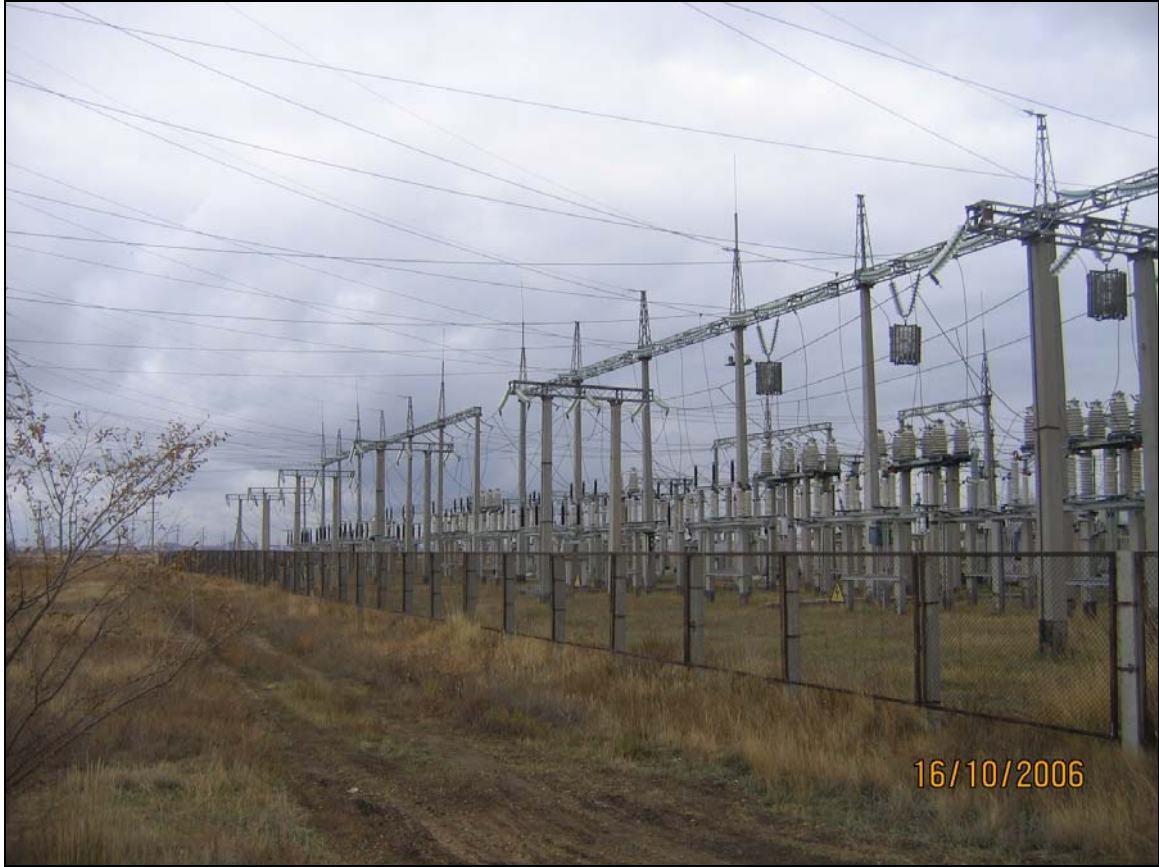
Подстанция поблизости площадки ВЭС
